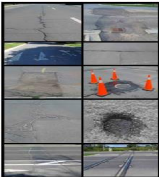
Slika 3: Oštećenja na cesti
